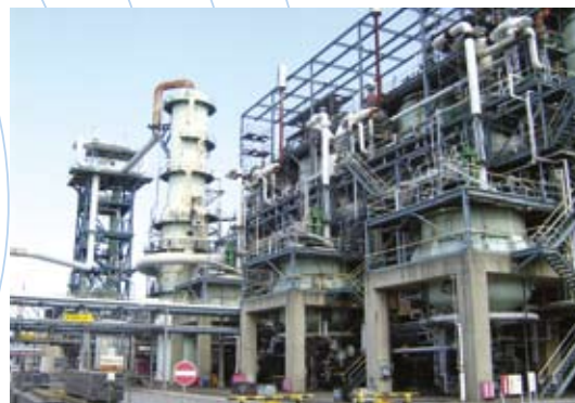
減圧残油熱分解装置
