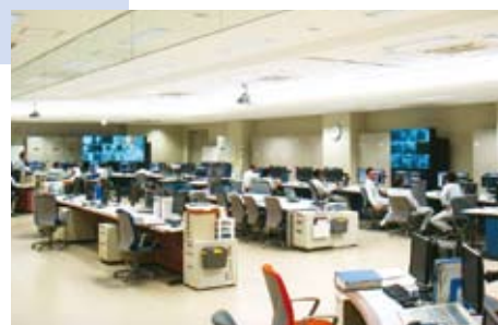
地震計に連動した装置自動停止システムを備えた統合計器室
