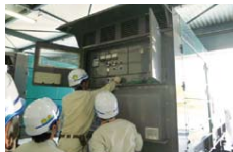
非常用発電機の試運転
