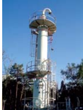
炭化水素回収装置
