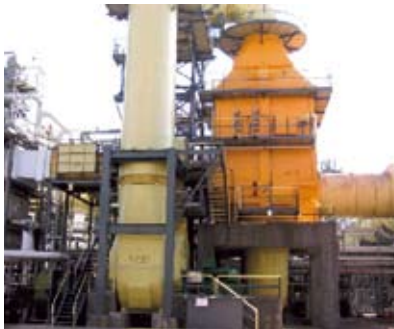
COボイラー排煙脱硝装置
