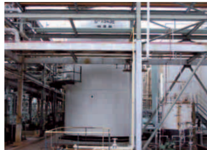
2009年6月に増設したろ過処理装置
