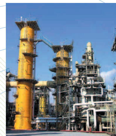
第4軽油水素化脱硫装置 (ディーゼル車排出ガスから出るSOx、NOx、PM低減対策のためサルファーフリーの軽油を生産します。)
