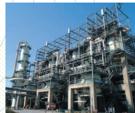
減圧残油熱分解装置
