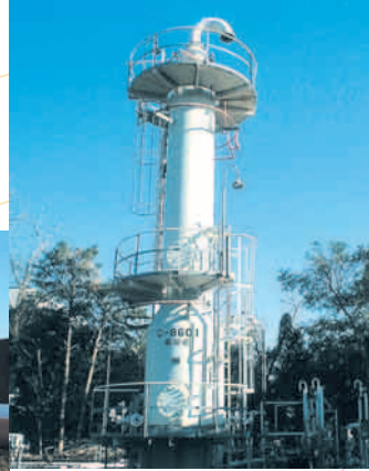
炭化水素回収装置
