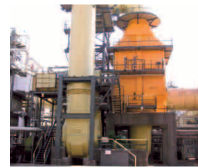
2009年6月に更新されたCOボイラー排煙脱硝装置
