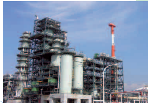
第2流動接触分解装置 (重油の製造を削減しガソリン生産などを拡大)
