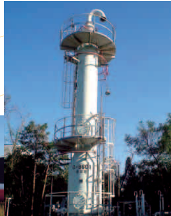
炭化水素回収装置
