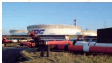
浮屋根式原油タンク
