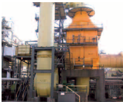
2009.6に更新されたCOボイラー排煙脱硝装置
