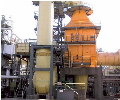
2009年6月に更新されたCOボイラー排煙脱硝装置
