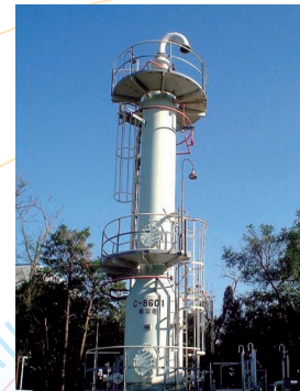
炭化水素回収装置
