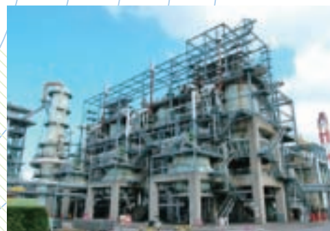
減圧残油熱分解装置
