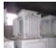
保管中の 高圧トランス
