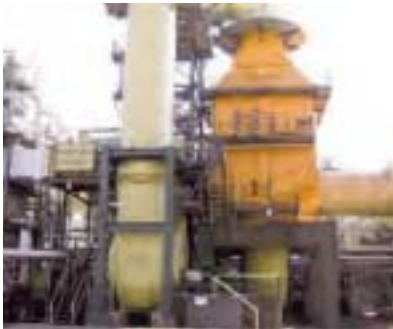
COボイラー排煙脱硝装置
