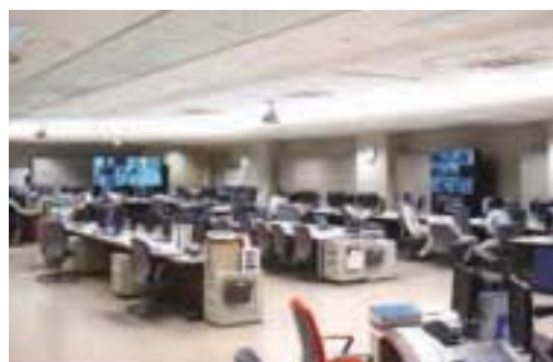
地震計に連動した装置自動停止システムがある統合計器室
