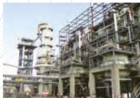
減圧残油熱分解装置
