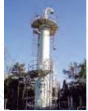
炭化水素回収装置
