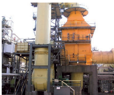
COボイラー排煙脱硝装置
