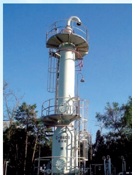
炭化水素回収装置
