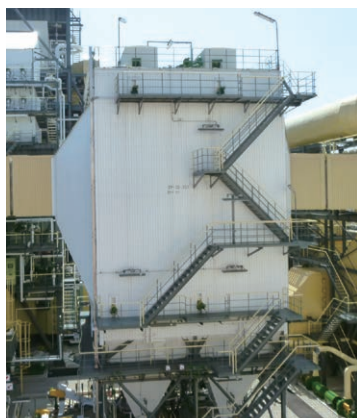
10号ボイラー発電所の 乾式電気集じん機
