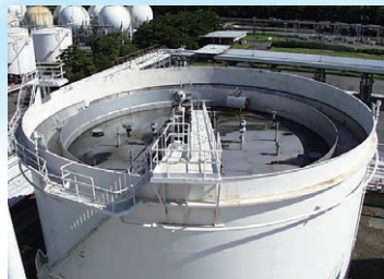
浮屋根式ガソリンタンク
