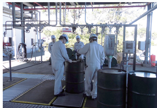
ドラム缶出荷設備取扱い訓練
