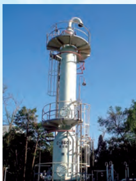
炭化水素回収装置
