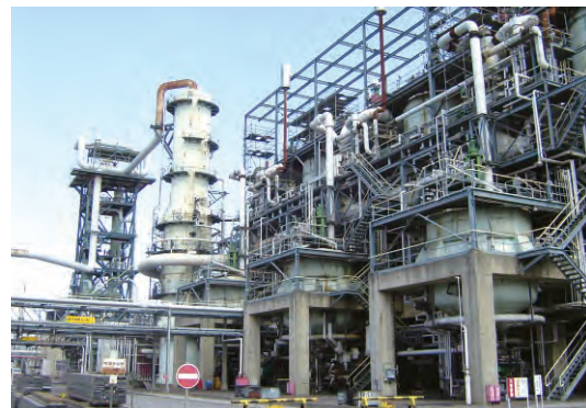
減圧残油熱分解装置
