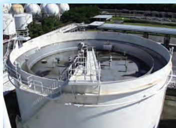
浮屋根式ガソリンタンク
