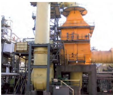
COボイラー排煙脱硝装置
