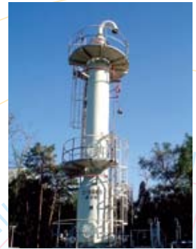
炭化水素回収装置
