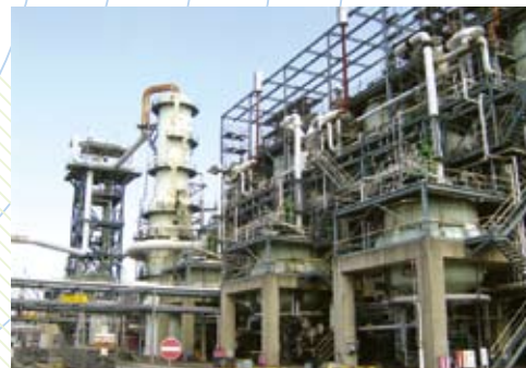
減圧残油熱分解装置
