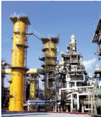
第4軽油水素化脱硫装置 (ディーゼル車排出ガスから出るSO x 、NO x 、PM低減対策のためサルファーフリーの軽油を生産)
