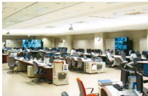
地震計に連動した装置自動停止システムがある統合計器室
