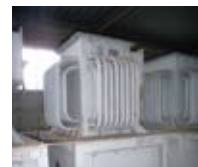
保管中の 高圧トランス
