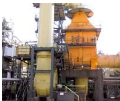
COボイラー排煙脱硝装置
