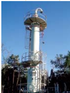
炭化水素回収装置
