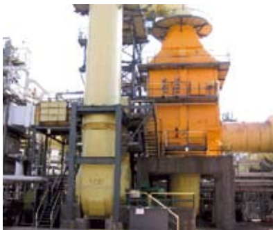
COボイラー排煙脱硝装置
