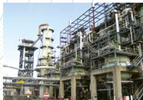
減圧残油熱分解装置
