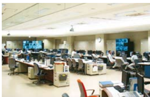
地震計に連動した装置自動停止システムがある統合計器室
