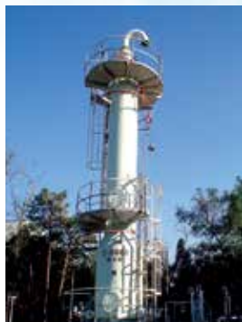
炭化水素回収装置
