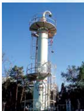
炭化水素回収装置
