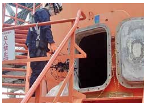
ドローンを用いた煙突内部点検 (入槽前の様子、ドローンは写真中央部の 煙突入槽口左側)
